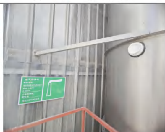
图 12 DA003 排放口监测采样监测孔
