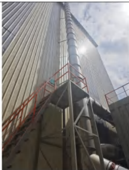
图 5 粗破和二破废气排放口 (DA001)
