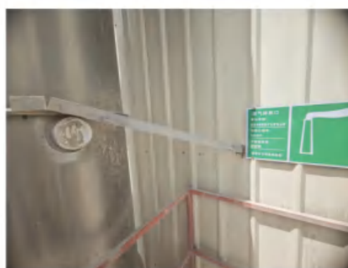
图 18 DA004 排放口标识牌
