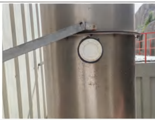
图 8 DA001 排放口监测采样监测孔
