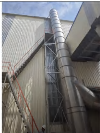
图 13 一级筛分废气排放口 (DA003)
