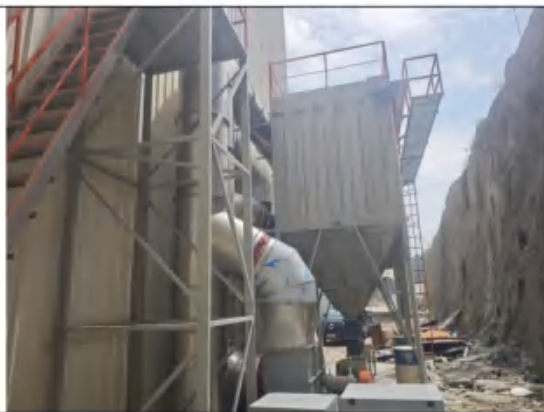
图 7 TA001 废气治理设施
