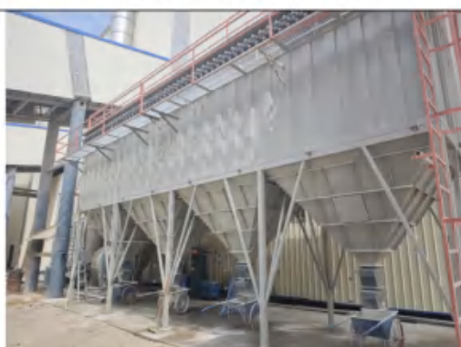
图 15 TA003 废气治理设施
