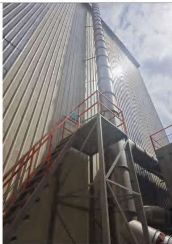
图 1 粗破和二破废气排放口（DA001）
