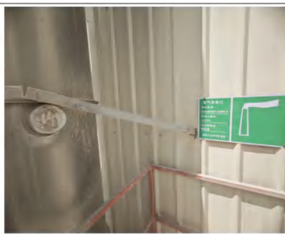
图 16 DA004 排放口监测采样监测孔
