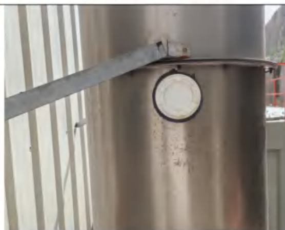
图 4 DA001 排放口监测采样监测孔
