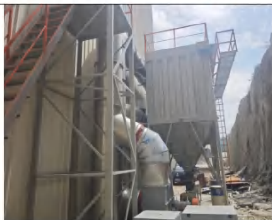
图 3 TA001 废气治理设施
