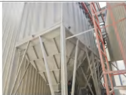
图 19 TA004 废气治理设施
