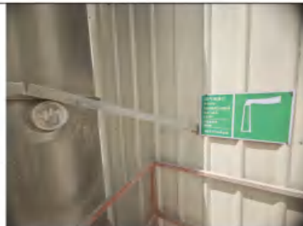
图 20 DA004 排放口监测采样监测孔
