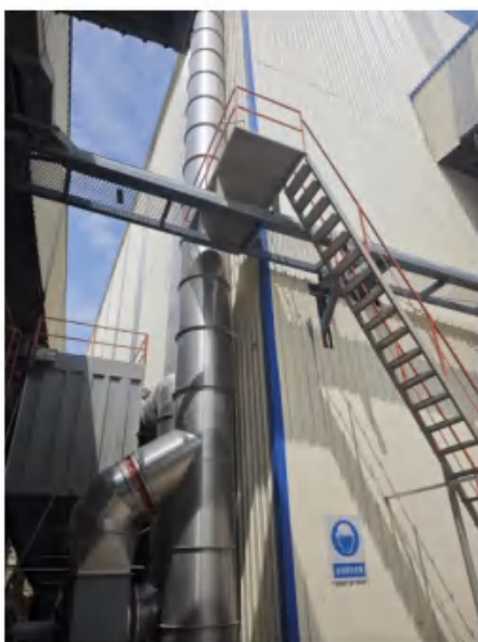
图 11 TA002 废气治理设施
