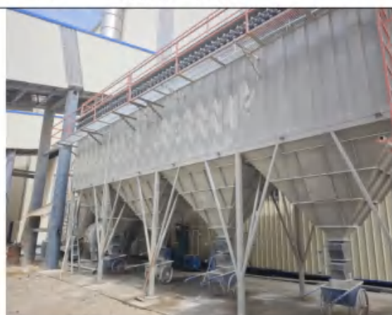
图 11 TA003 废气治理设施
