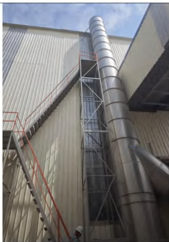
图 9 一级筛分废气排放口 (DA003)
