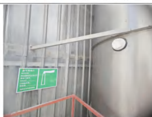
图 16 DA003 排放口监测采样监测孔
