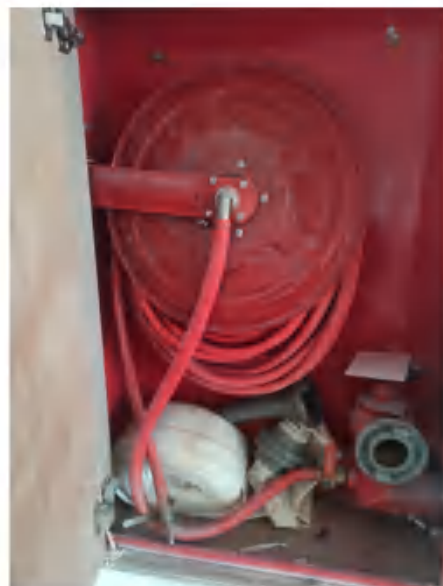
厂区消防器材
