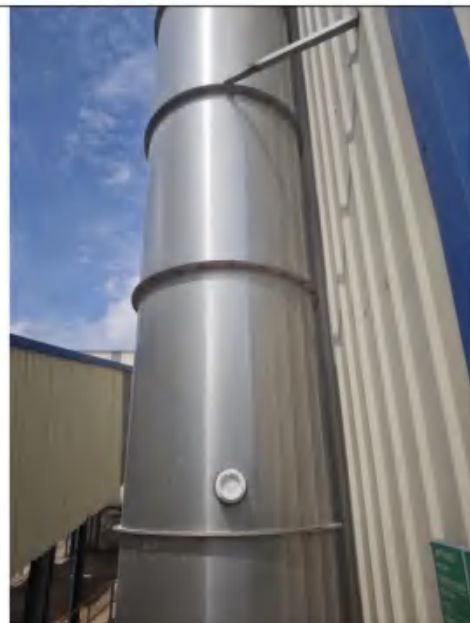
图 12 DA002 排放口监测采样监测孔
