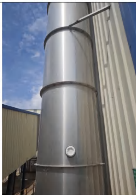
图 8 DA002 排放口监测采样监测孔
